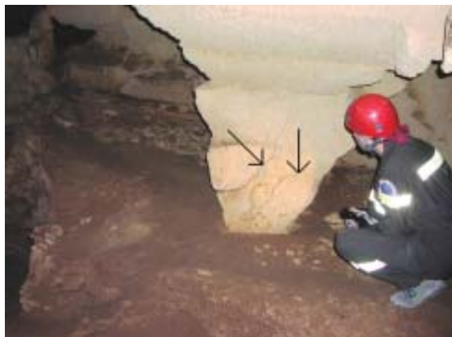
Foto 5 – Esempio di pilastro con fratture imputabili a schiacciamento (sopralluogo del 12 maggio 2007)
