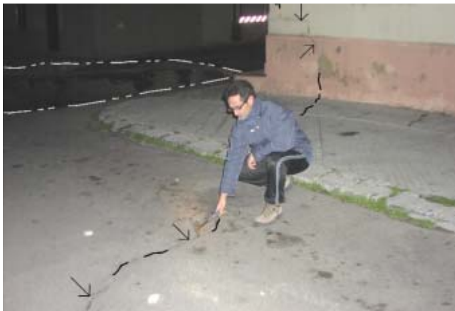
Foto 1 – Rilievi delle crepe sugli edifici coinvolti nel dissesto e lungo le strade (sopralluogo del 30 marzo 2007). L'ampliamento del 1 aprile si imposterà lungo la frattura evidenziata e indicata dal martello (cfr. figura 3)
