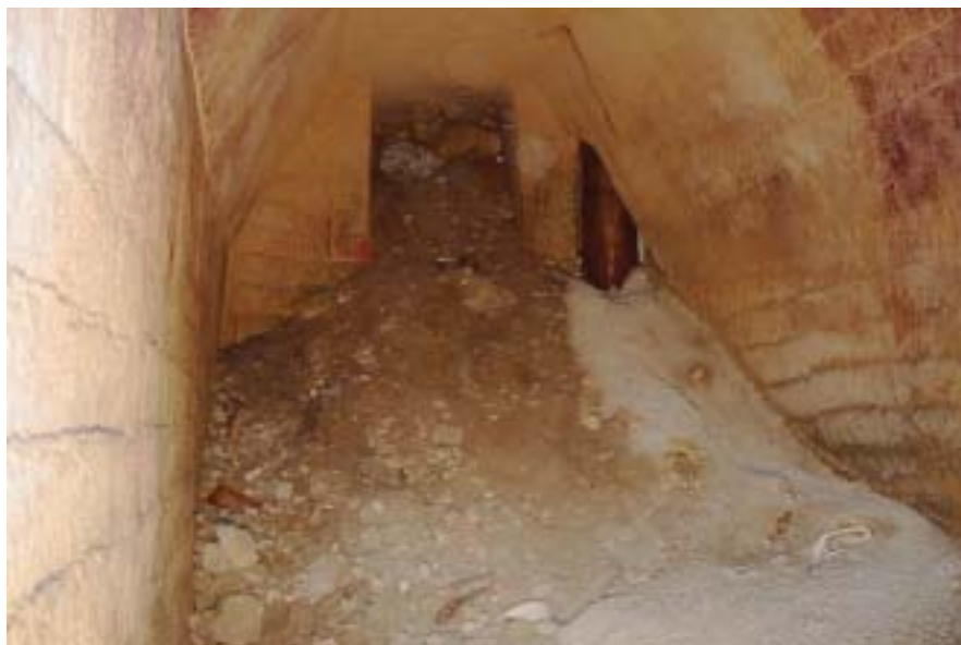
Canosa di Puglia (BA), cavità antropiche parzialmente riempite da materiale di scarto. Sul lato destro si nota la camicia di un palo di fondazione con parte della gettata di calcestruzzo fuoruscita dalla stessa. Foto Ing. S. Germinario
