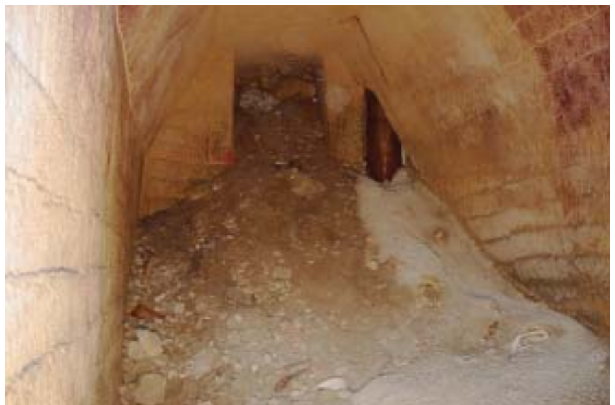
Canosa di Puglia (BA), cavità antropiche parzialmente riempite da materiale di scarto. Sul lato destro si nota la camicia di un palo di fondazione con parte della gettata di calcestruzzo fuoruscita dalla stessa. Foto Ing. S. Germinario
