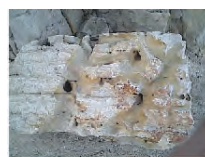
Figura 9 - Condotti carsici sulla falesia in roccia calcarea a 2 m circa sopra il lm attuale ancora occasionalmente attivi. Costa a N di Bisceglie (Ba)
