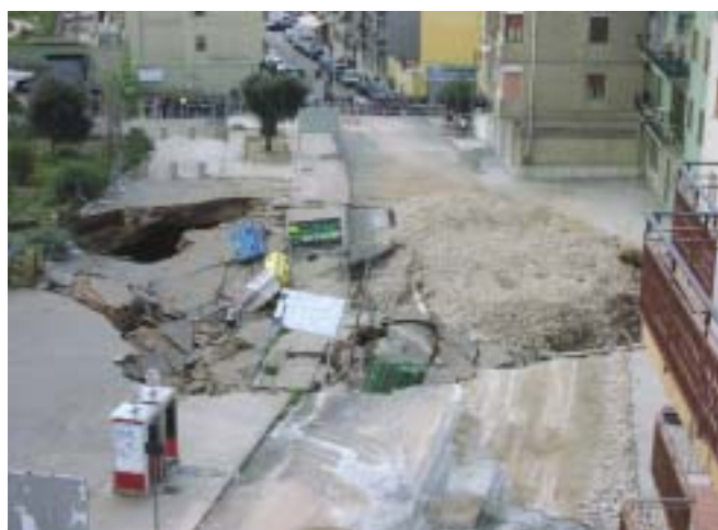
Foto 4 – Panoramica della voragine (sopralluogo del 1 aprile 2007). Si osservi la superficie sfaldata e nel complesso ondulata dell'area interessata dall'ultimo evento di ampliamento
