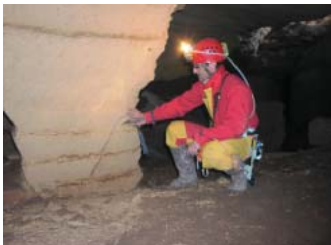
Foto 3 – Una fase dell'esame del quadro fessurativo di un pilastro (sopralluogo del 30 marzo 2007)
