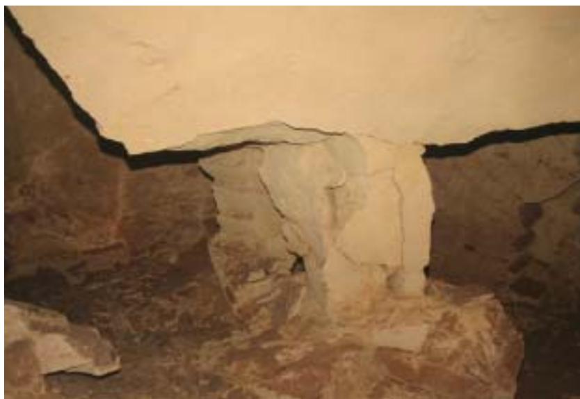
Foto 7 – Cedimenti ed espulsione di materiale caratterizzano buona parte delle strutture di sostegno
