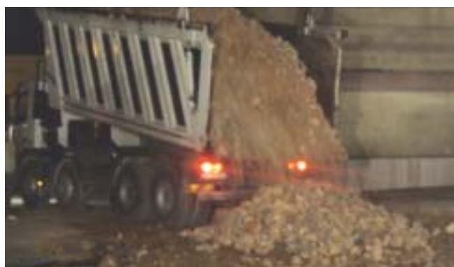
Foto 10 – Le operazioni di spargimento di materiale per il riempimento della voragine
