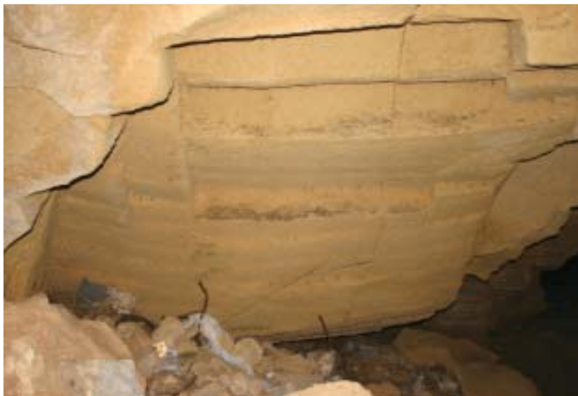
Foto 14 – A circa 50 m dalla zona dove è avvenuto il crollo, in prossimità del nuovo ingresso ricavato per permettere i lavori di consolidamento, una parete evidentemente fratturata evidenzia come il quadro del dissesto sia esteso su una superficie ben più ampia
