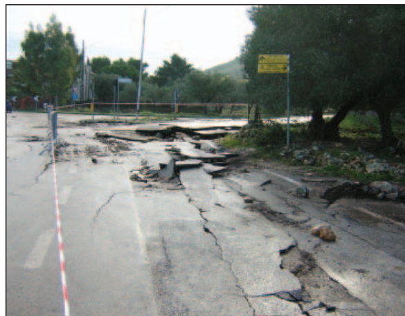
Foto 10.3 - Danni causati dalla forza erosiva
