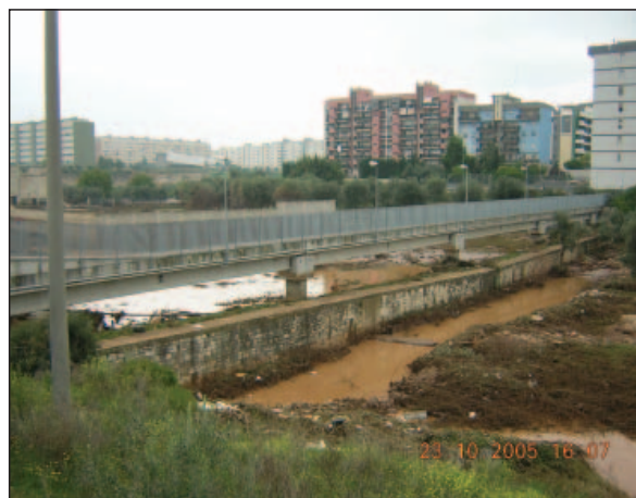
Foto 11.5 - Attraversamento pedonale dell'alveo del T. Picone, a monte del canale deviatore, che ha fatto da ostacolo all'onda di piena
