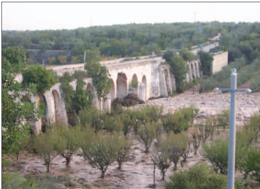
Foto 11.9 - Letto del T. Badessa a valle del ponte della Strada Provinciale Cassano-Sannicandro. L'incremento della forza erosiva dell'acqua, dovuto al restringimento della sezione di flusso ad opera delle luci del ponte, ha causato l'erosione del deposito alluvionale e l'affioramento del substrato calcareo
