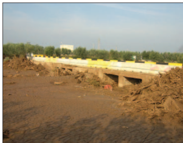
Foto 11.7 - Tombinatura della Strada Provinciale Bitritto-Loseto parzialmente ostruita dal materiale per insufficienza di luce
